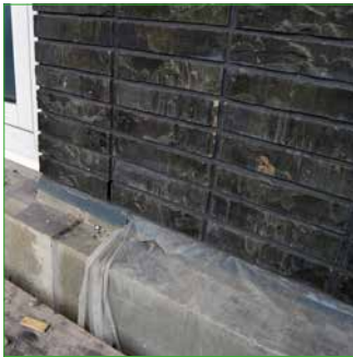
Compri LV onder metselwerk
